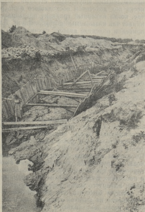
Фото 2. Авария в траншее для канализационного коллектора в результате внезапного разжижения и выпирания морского песка.
